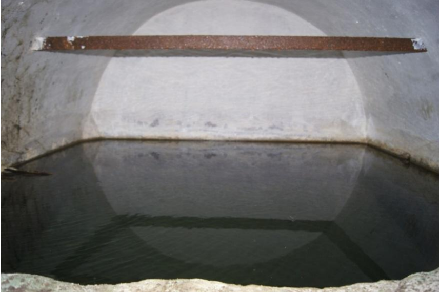
Foto 9: Bağarası Camikebir Çeşmesi Depo Kısmı
