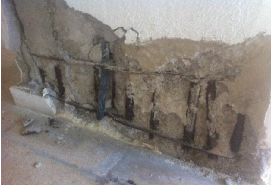
Şekil 4. Binanın kolonlardaki genel durum
