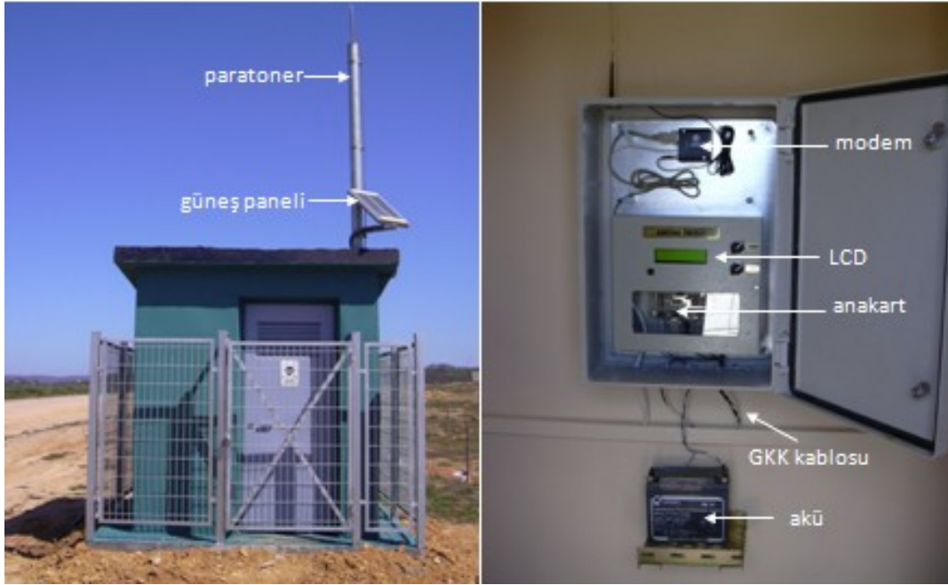
Şekil 4. Ölçüm istasyonu ve içinde yer alan ölçüm panosu (Measurement station and its measurement panel in it)
